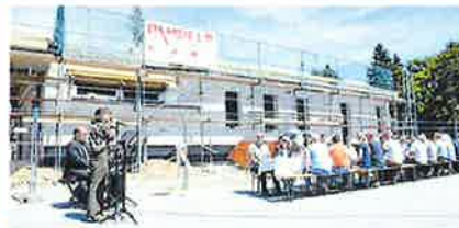
Feier mit Musik. Rund eine Million Euro wird in das neue Gebäude gegenüber dem Gutshof investiert.
